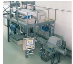
Extruder OEE in einer Petfoodanlage
