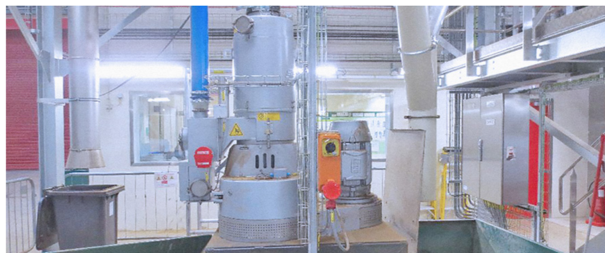
↑ Presse à granuler dans une installation de production d'aliments
